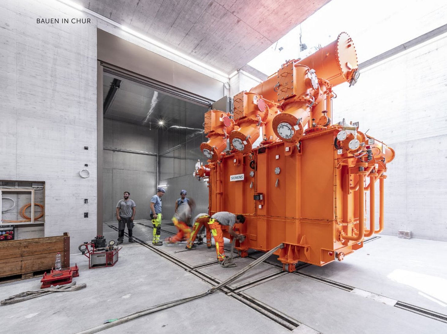
Die beiden grossen Transformatoren werden wie im Bild aus dem Unterwerk Quader komplett im Untergrund eingebaut. Sind sind das Herzstück des neuen Unterwerks Lacuna.
