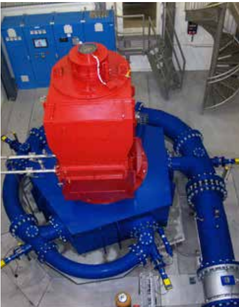
Die neue Rabiosa-Maschine dient auch zur Inselversorgung des Kraftwerkes bei Netzausfall und erzeugt knapp 5 Mio. kWh Strom.
