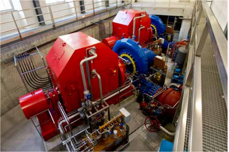
Die beiden leistungsstarken Maschinensätze, bestehend aus zwei Andritz-Francis-turbinen und je einem direkt gekoppelten Elin-Generator, erzeugen in einem durchschnittlichen Produktionsjahr rund 48 Mio. kWh sauberen Strom aus der Kraft der Plessur.
